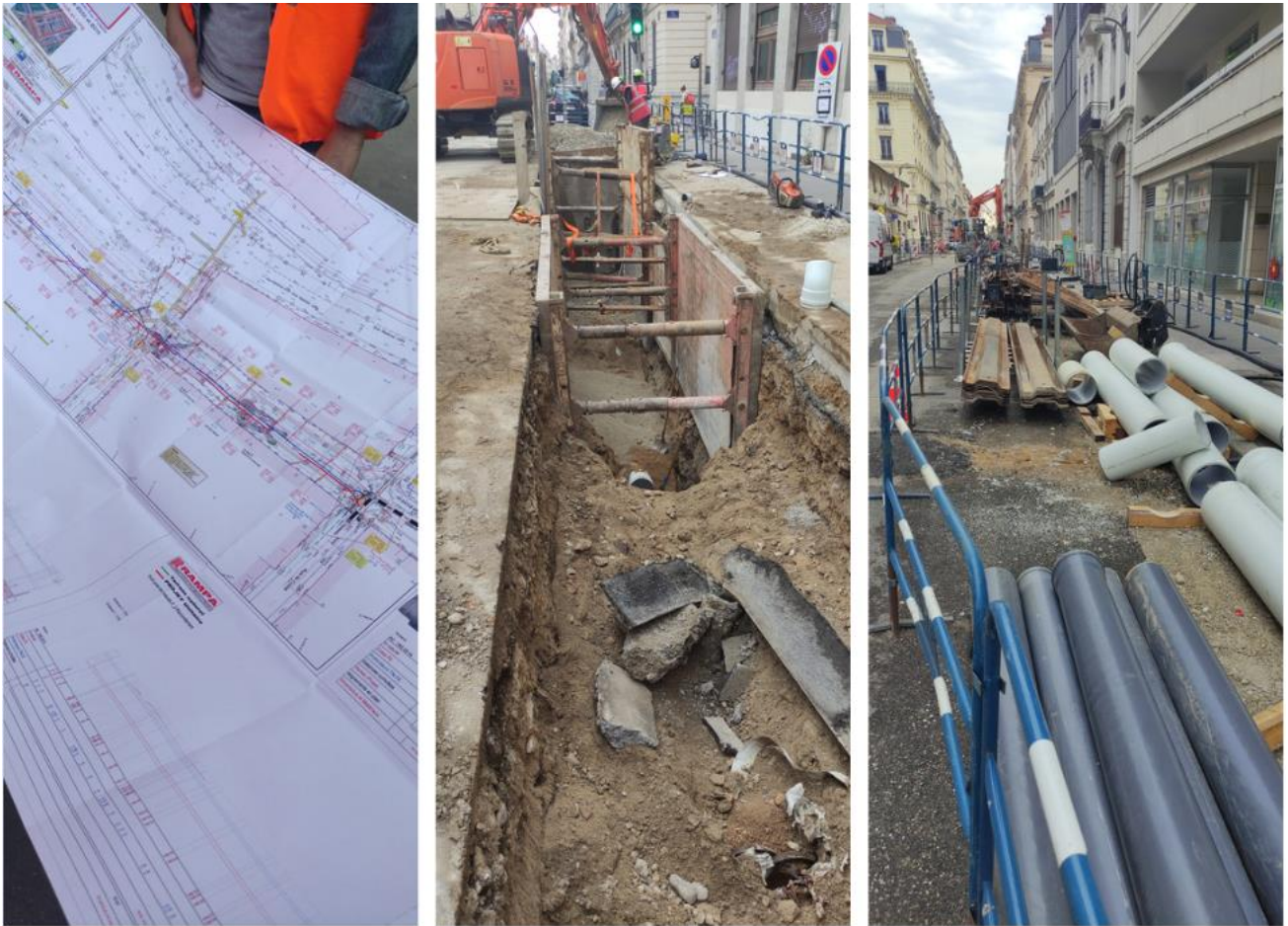
Visite de travaux en bord du Rhône pour raccorder des immeubles historiques au réseau d'assainissement.
